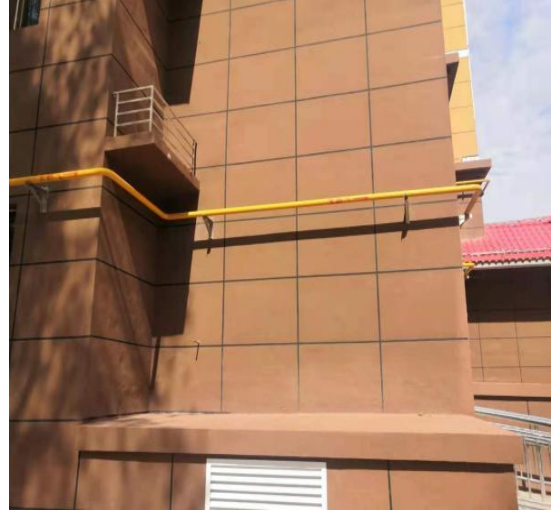
地下车库排风口
